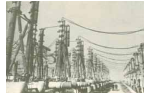
Skirstykla prieš rekonstrukciją
