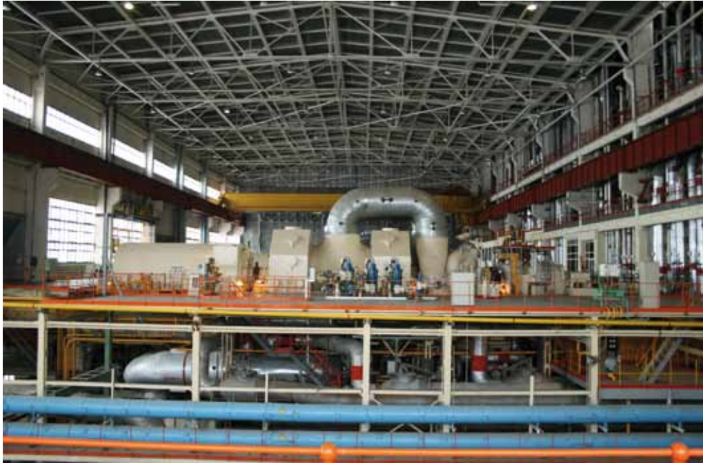
Vilniaus elektrinės (TE-3) turbinų salė
