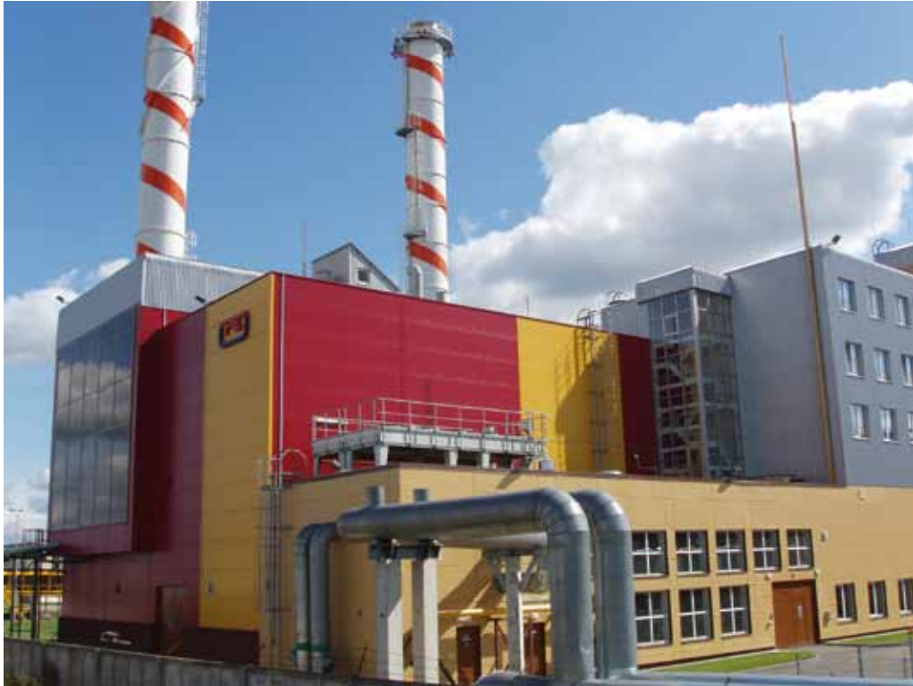
Panevėžio termofikacinė elektrinė
