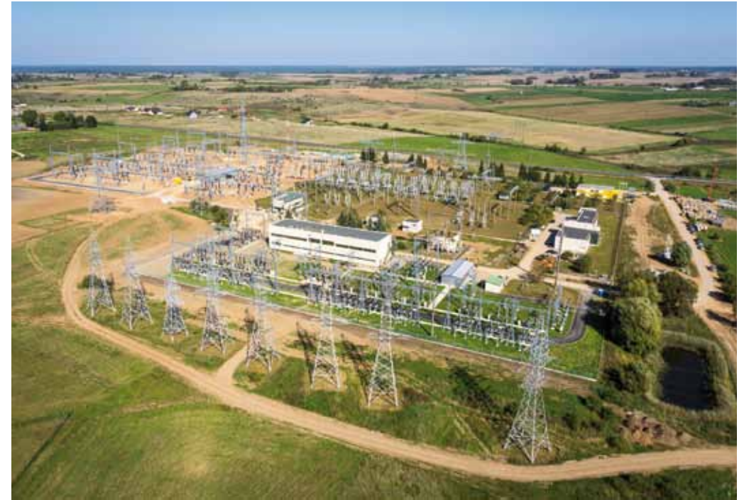
Alytaus transformatorių pastotė, 2014-09-23
