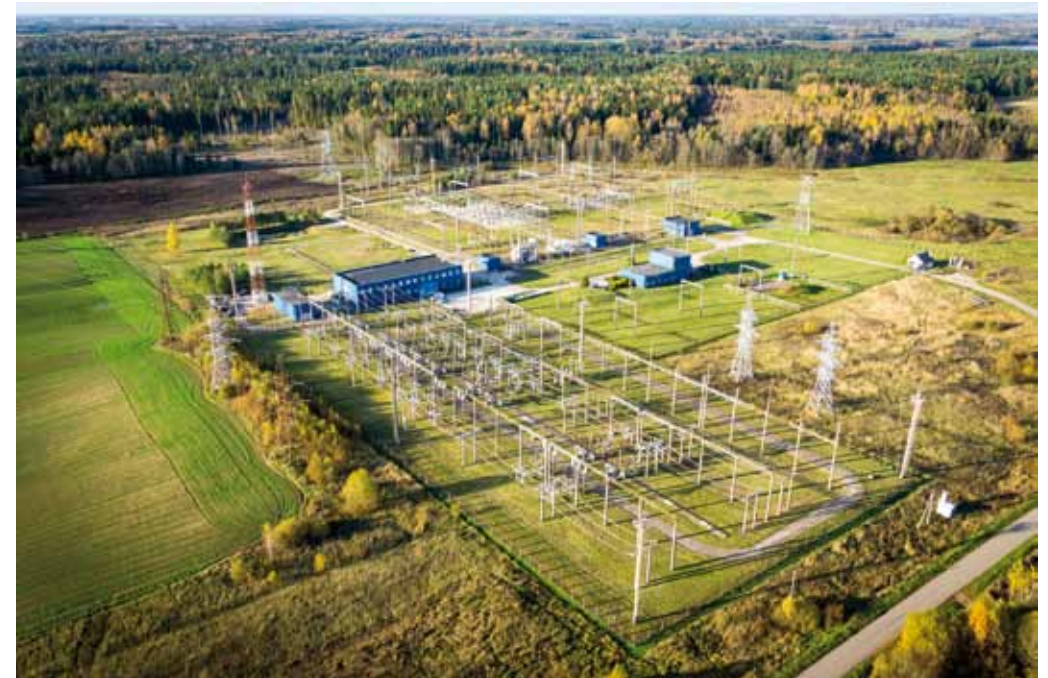
Telšių 330 kV pastotė
