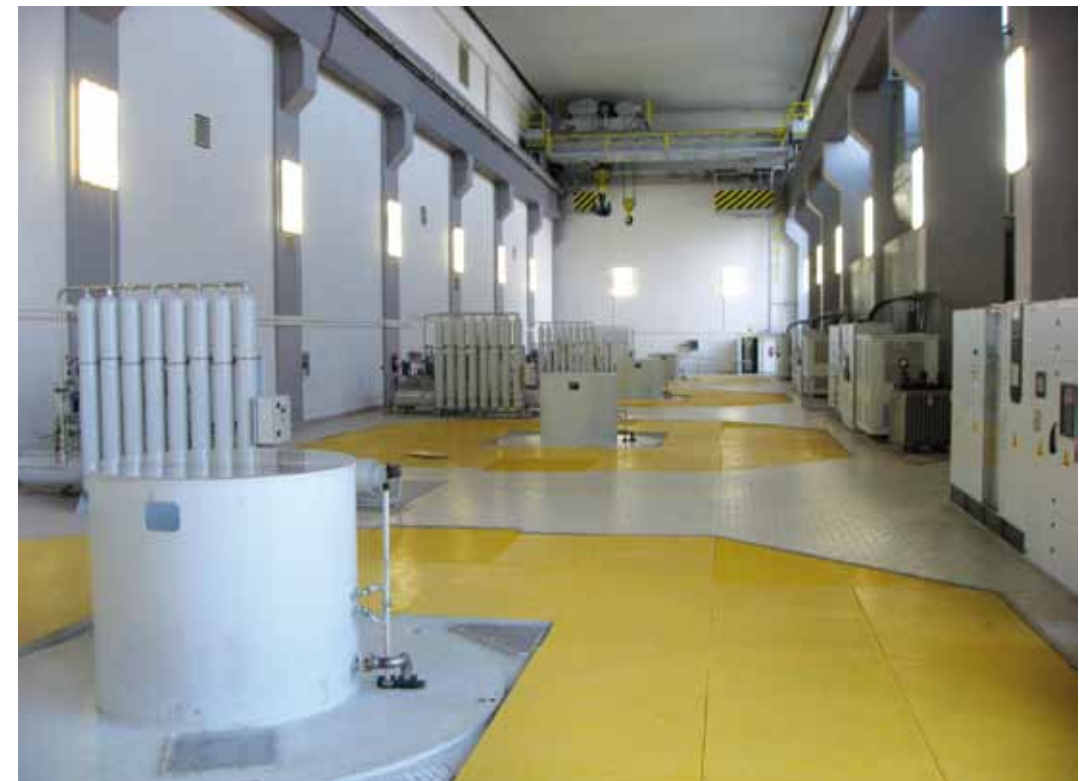
KHE mašinų salė po rekonstrukcijos
