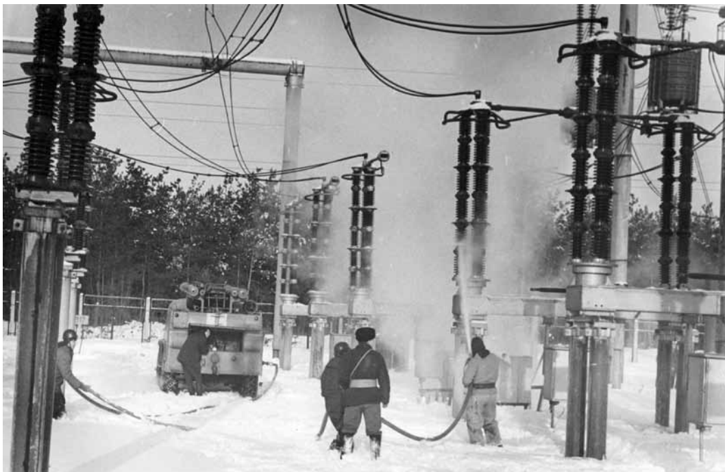
Elektros izoliacijos plovimas 330 kV Jonavos transformatorinėje pastotėje nuo Jonavos trąšų gamyklos nusėdusių izoliacijai pavojingų teršalų
