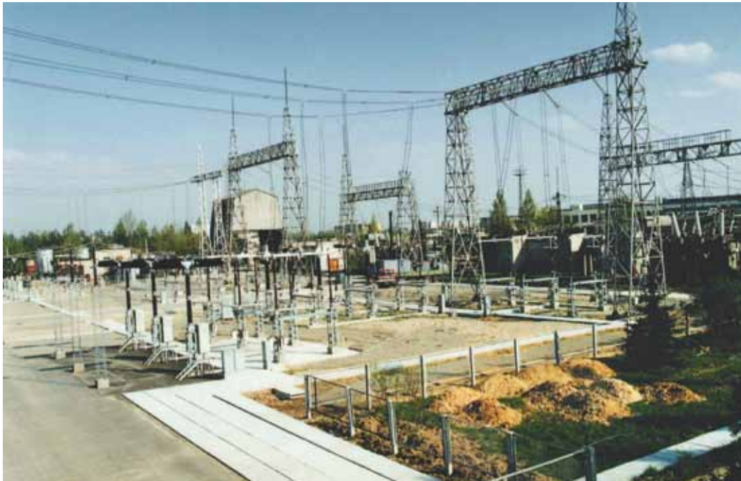
330 kV skirstomieji įrenginiai po rekonstrukcijos
