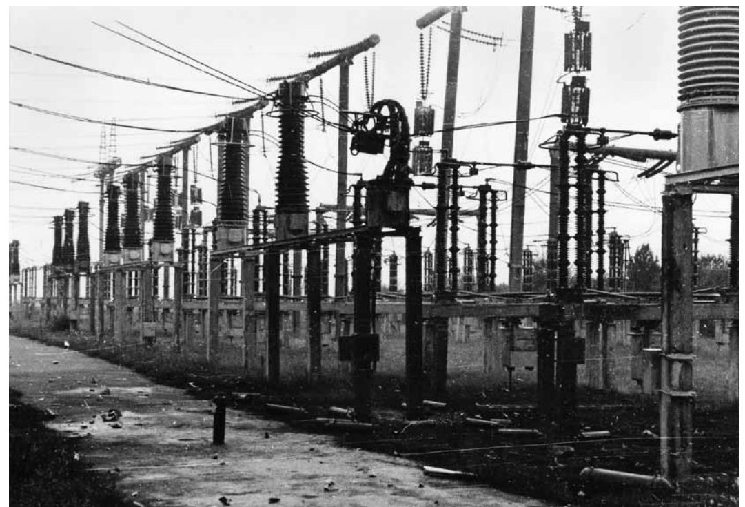
Kauno pastotės 330 kV skirstykla, sprogus 330 kV srovės transformatoriui, 1976 m.
