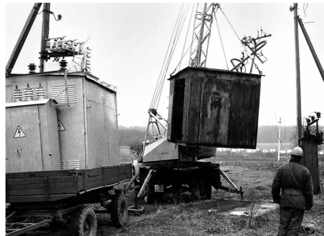
Komplektinės transformatorinės pastotės keitimas Alytaus elektros tinklų rajone, 1986 m.
