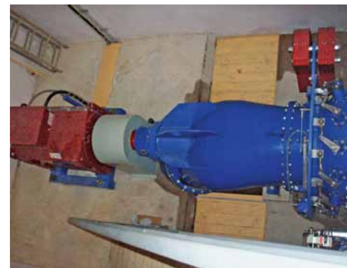
Hidroelektrinės pastato viduje
