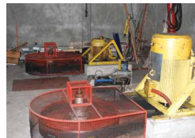
Hidroelektrinės pastato viduje
