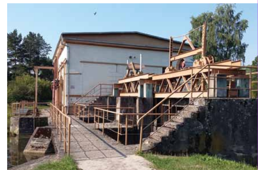
Potvynių pralaidos skydų valdymo mechanizmai
