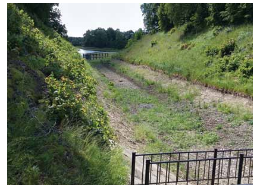
Renavo HE įtekėjimo dalies kanalo vaizdas užtvankos remonto metu 2015 m.
