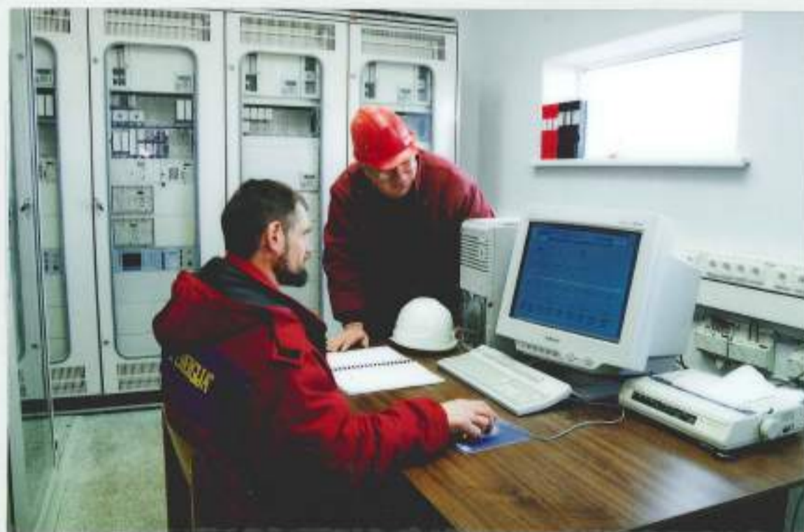
Raseinių 110 kV pastotės valdymo pultas
