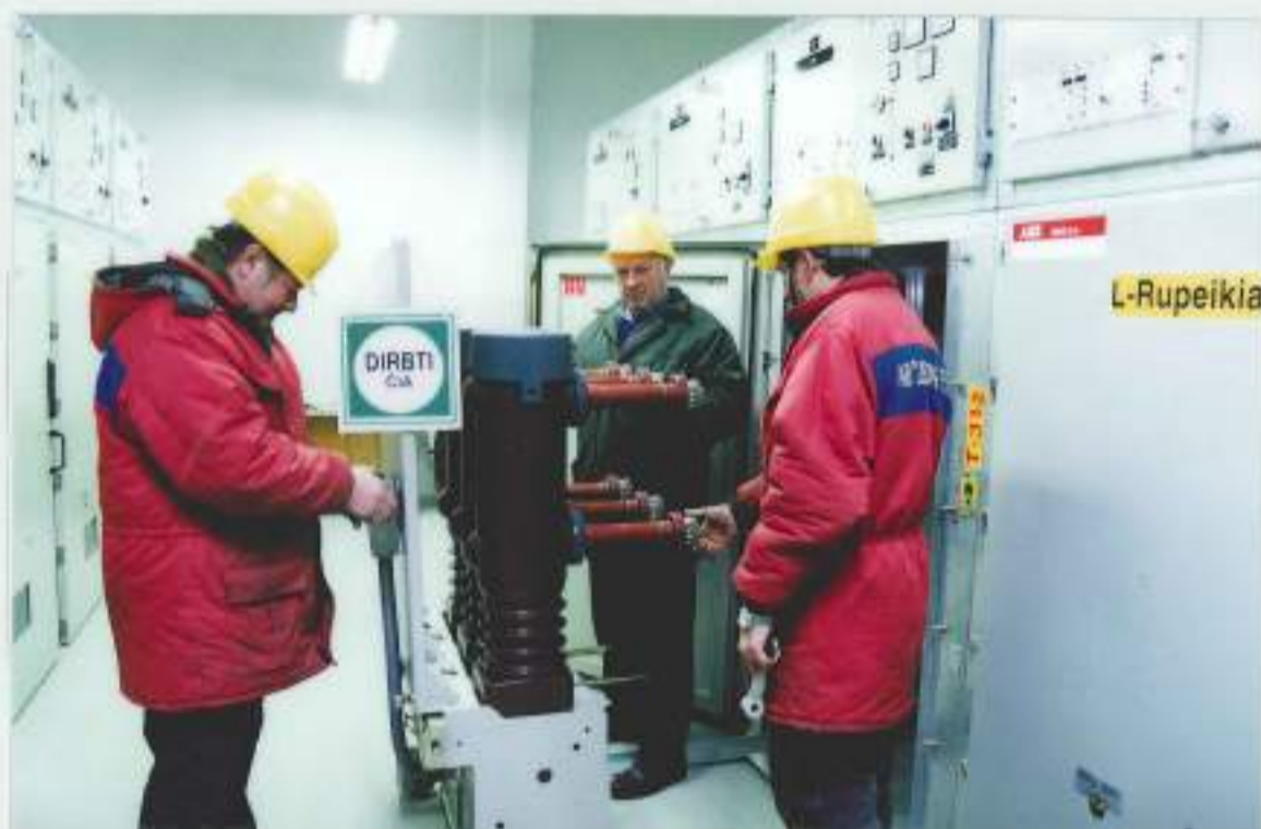
Raseinių 110 kV pastotės 35 kV uždari skirstomieji įrenginiai
