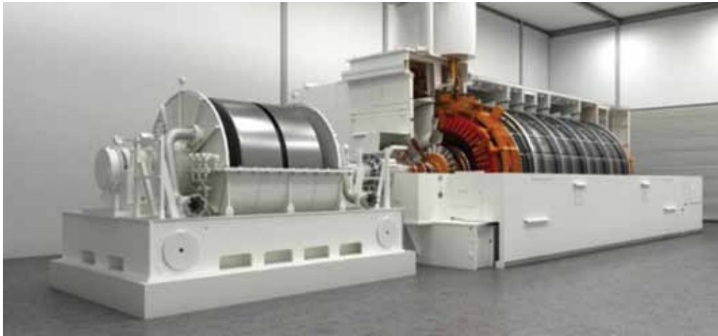
2-18 pav. Sinchroninis kompensatorius (Šaltinis: „Siemens Energy“)
