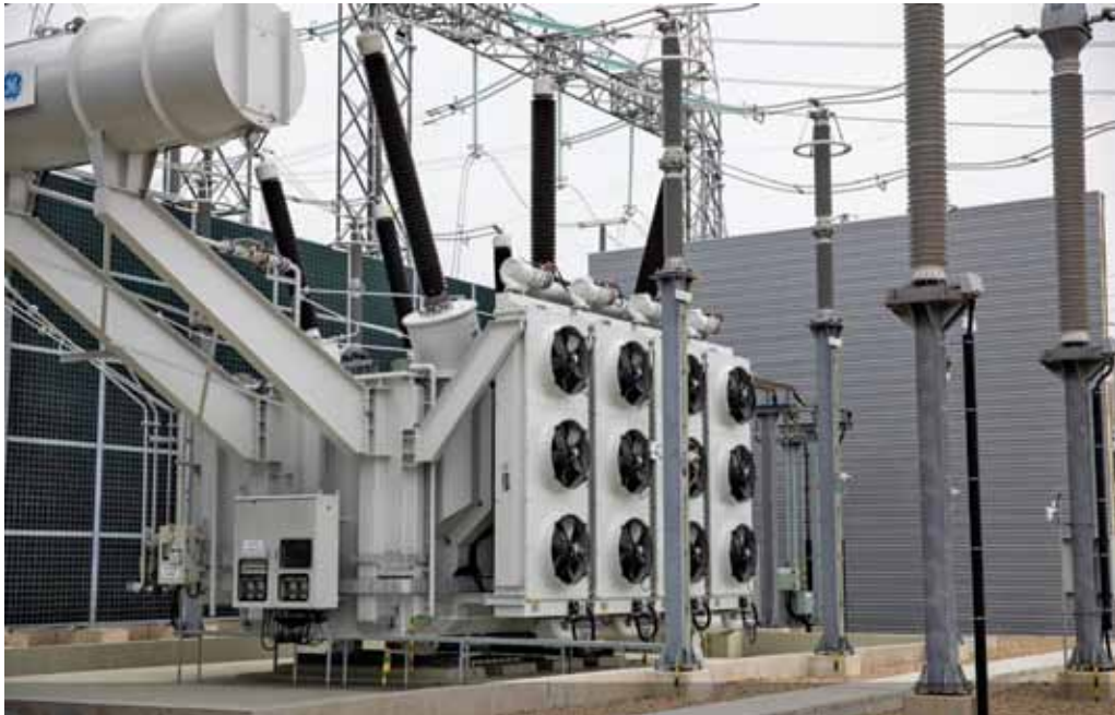
2-16 pav. Alytaus TP sumontuotas (vienas iš trijų) 410/345/10,5 kV, 600 MVA galios autotransformatorius (Šaltinis: „Litgrid“)
