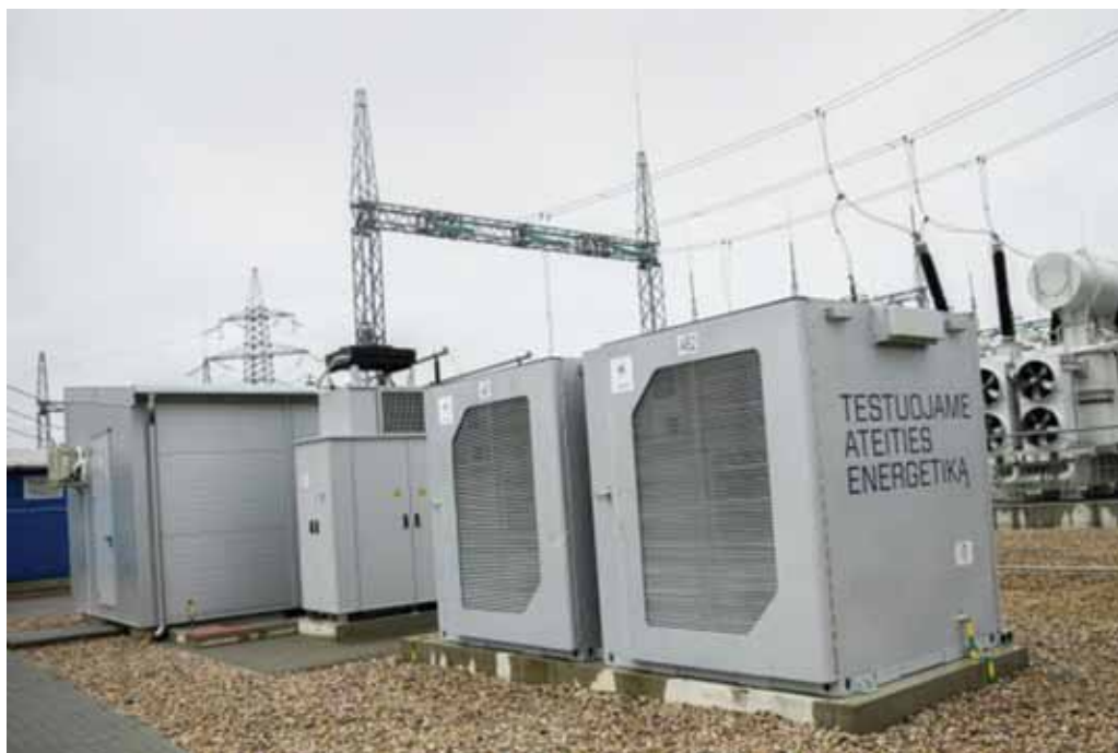
2-17 pav. 1 MW baterijų energijos kaupimo sistema įrengta 330 kV Vilniaus TP (Šaltinis: „Litgrid“)
