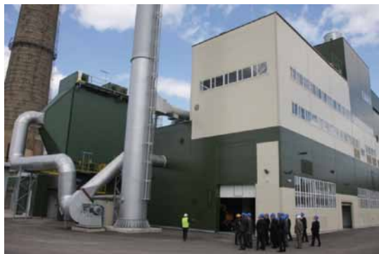
UAB „Litesko“ Alytaus biomasės kogeneracinės elektrinės korpusas su elektrosstatiniu dūmų filtru (2012 m. gegužės 18 d.)
