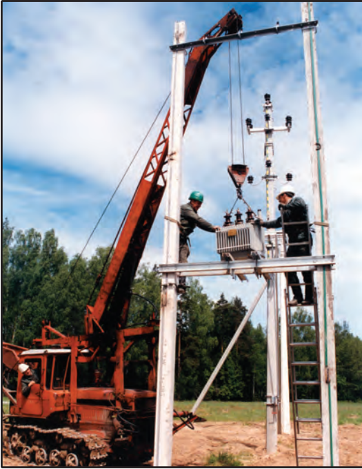
Montuojama stulpinė pastotė Zarasų rajone. 2001 m. gegužė
