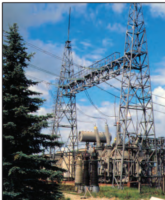
1984 m. pradėtos montuoti 330 kV įtampos transformatorinės pastotės
