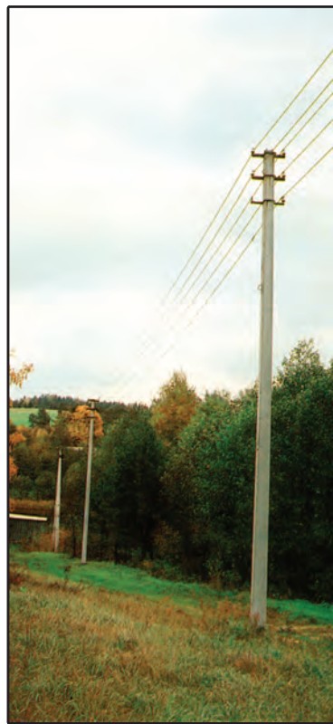
0,4 kV elektros tiekimo linija
