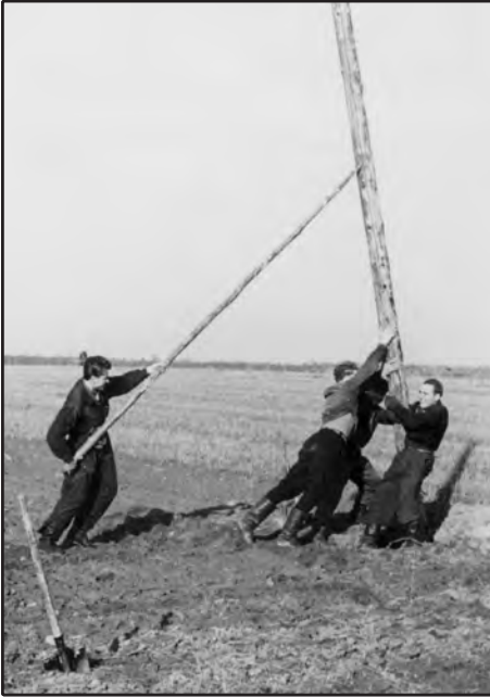
Statoma 0,4 kV ETL medinė atrama. 1962 m.
