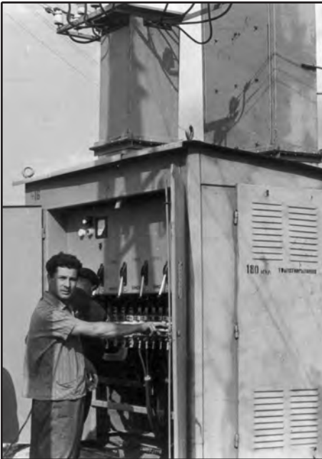
KT transformatorinė pastotė, 0,4 kV. Meistras A. Dovidauskas reguliuoja kirtiklius. 1974 m.
