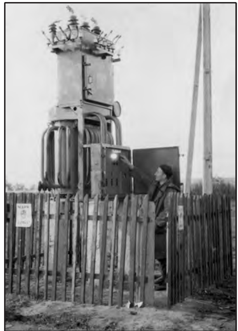
Į Minsko tipo KTO paduota įtampa, dega elektros lemputė. Elektromonteris A. Bendžius
