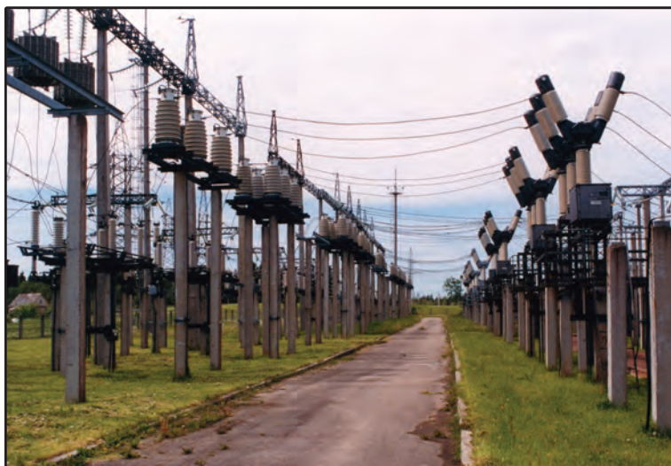
Utenos 330 kV transformatorinė pastotė. 2001 m. gegužė
