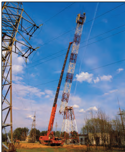
Statomas radijo relinės linijos bokštas
