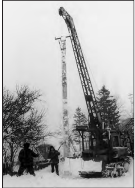
Mašina BKGO-67 statoma 0,4 kV ETL gelžbetoninė atrama
