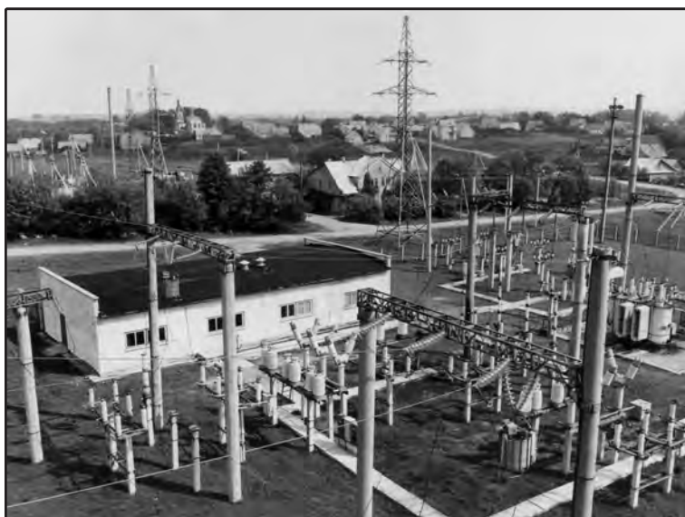
Dūkšto transformatorinė pastotė, 110/35 kV
