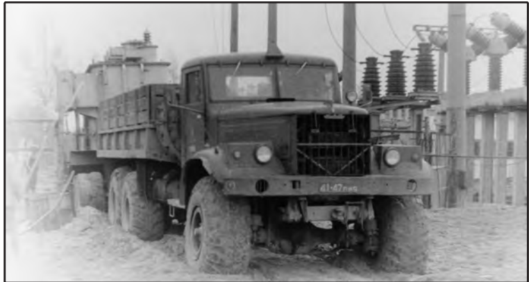
Transformatorius pristatytas į montavimo vietą. 1978 m.
