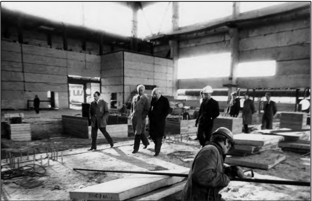
Nuotraukose: Vilniaus TE-3 statybos eigoje nuolat lankėsi ir savo patarimais daug padėjo Vyr. gamybinės energetikos ir elektrifikavimo valdybos viršininkas J. Nekrašas
