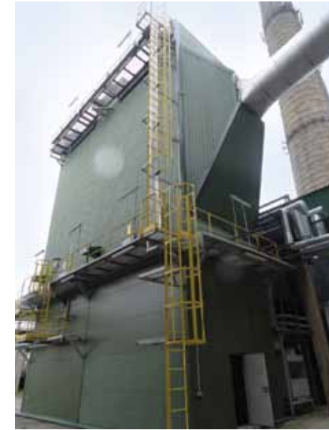
Alytaus katilinės dūmų elektrostatinis filtras
