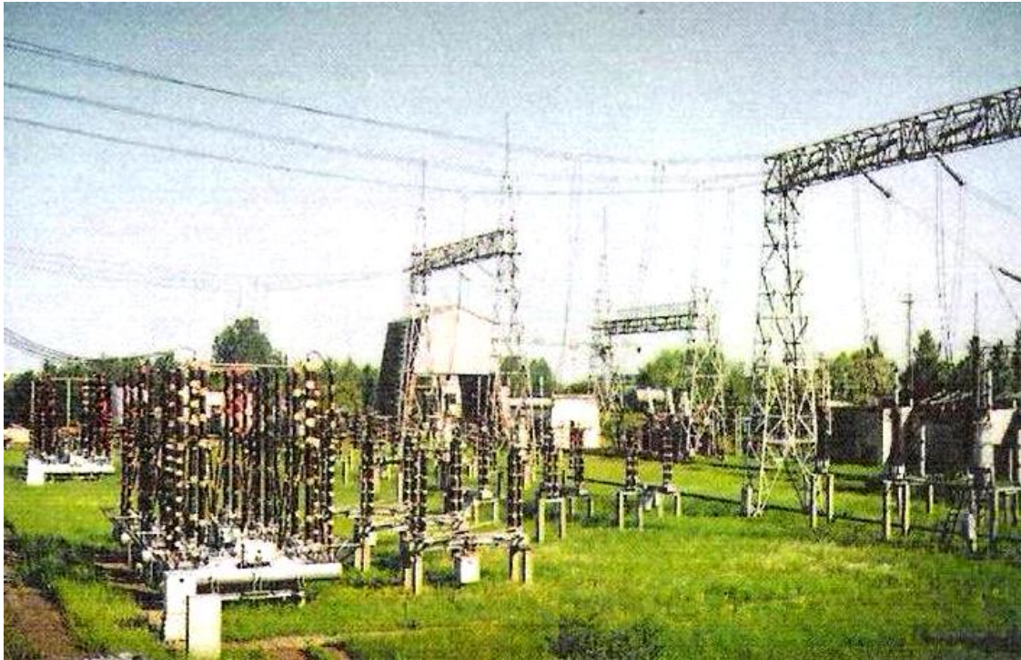
330 kV skirstykla 1985 m.
