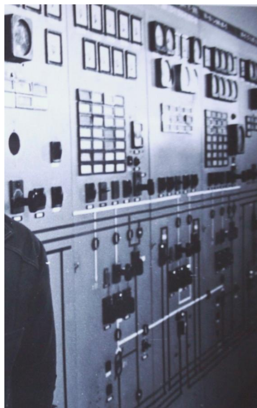
330 kV ETL ir AT valdymo paneliai
