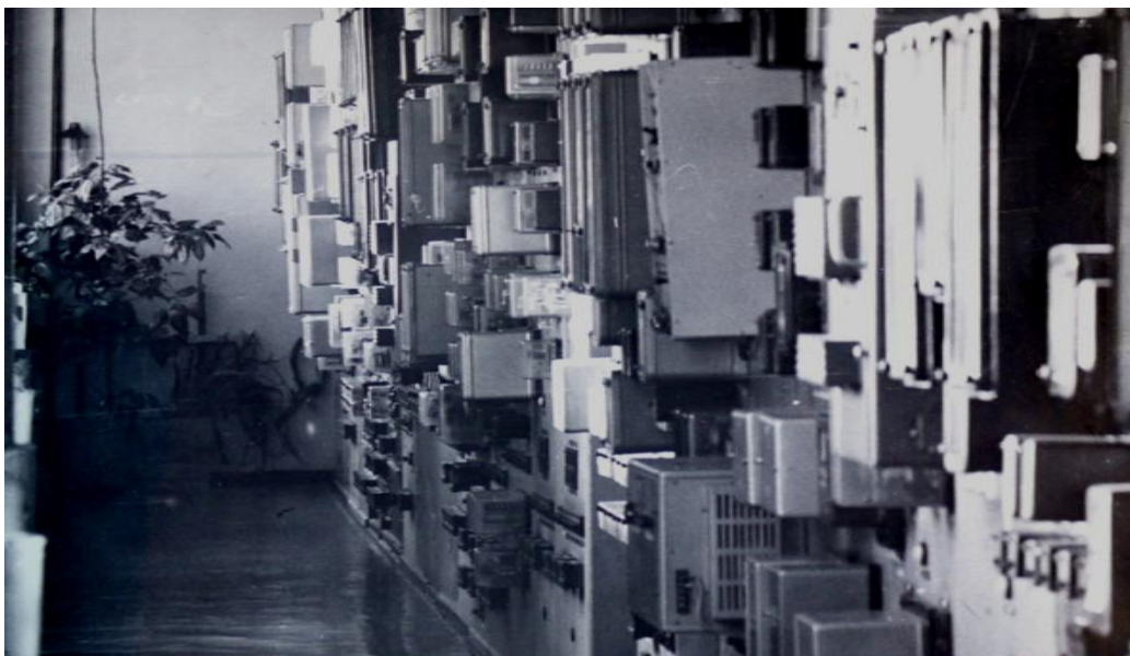
330 kV ETL ir autotransformatorių RAA paneliai (1968 m.)
