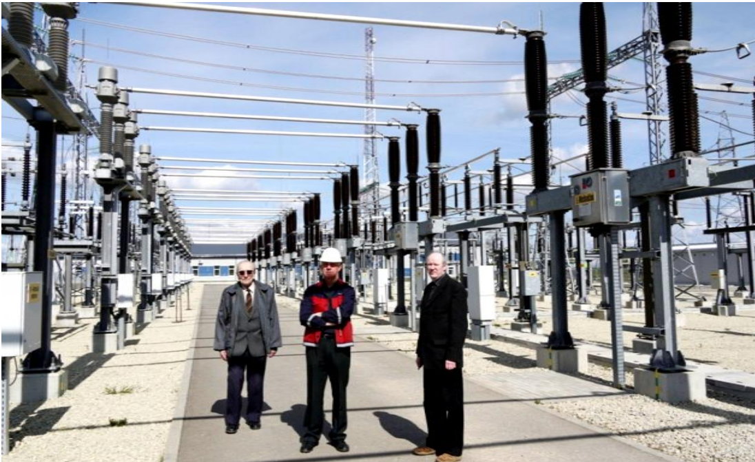
110 kV skirstykla 2015 m.
