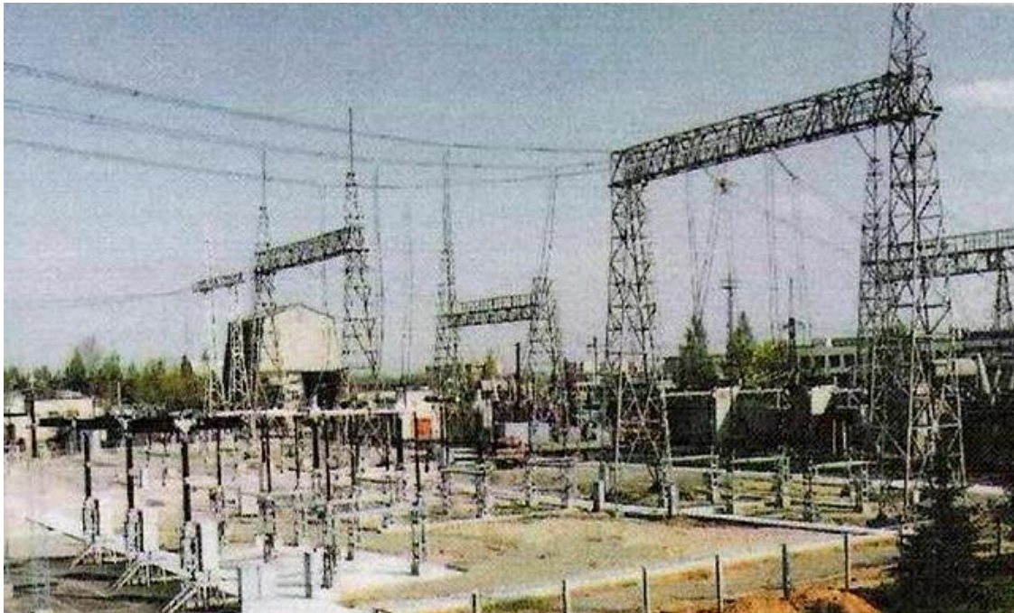
330 kV skirstykla 1999 m.
