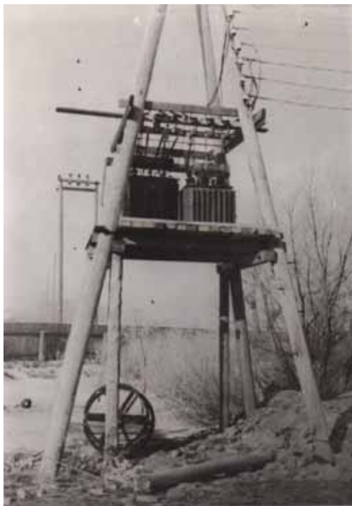
Biržų 20/0,4 kV TP, 1942 m.
