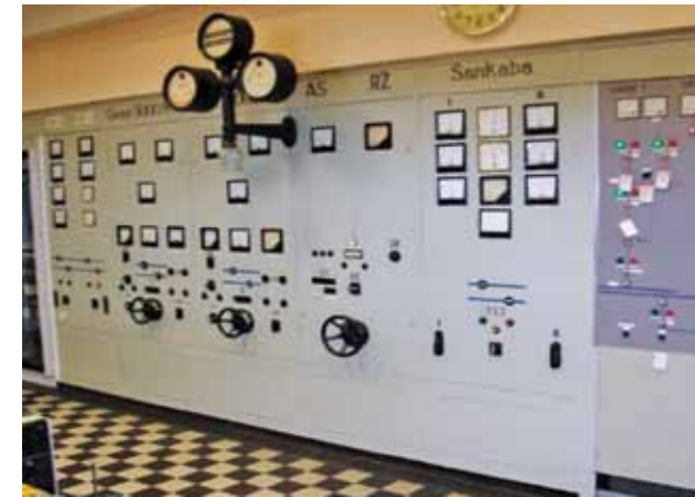
Dalis 1929 m. elektrinės centrinio valdymo pulto dar veikia, 2016 m.
