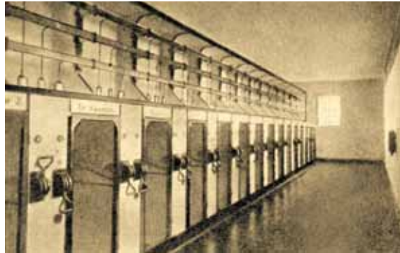
Klaipėdos šiluminės elektrinės aukštos įtampos skirstykla, 1929 m. (Energetikos ir technikos muziejaus fondo)
