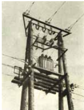
6/0,4 kV transformatorinė pastotė Vilniaus priemiestyje
